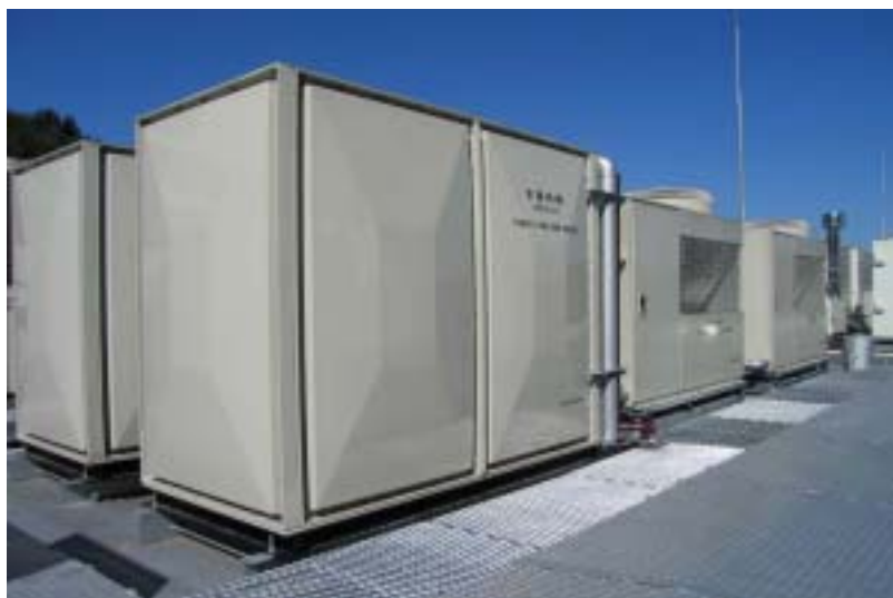
氷蓄熱槽（本部棟屋上）
