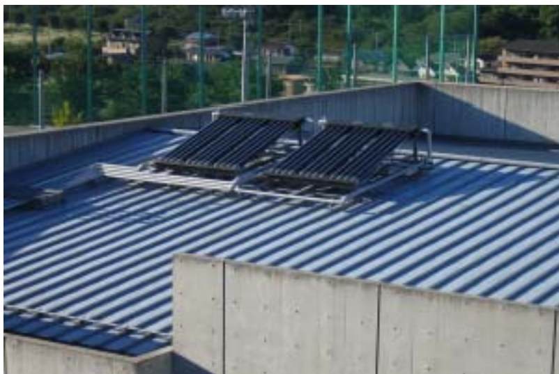
太陽熱利用温水設備（T A Uホール屋上）
