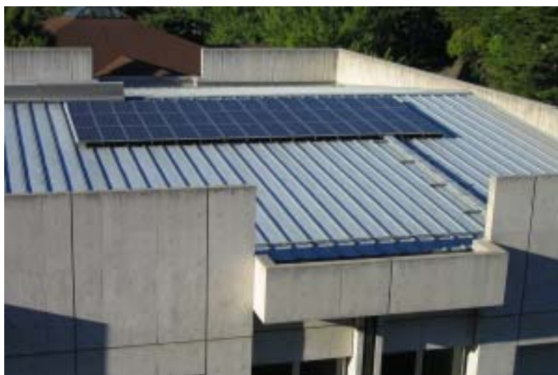
太陽光発電設備（T A Uホール屋上）
