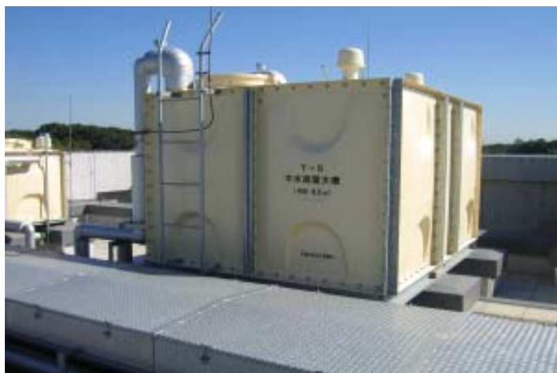
中水高架水槽（本部棟屋上）
