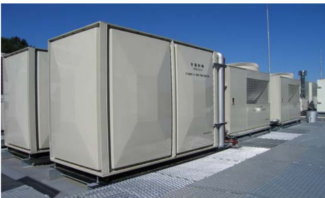
氷蓄熱槽(本部棟屋上)
