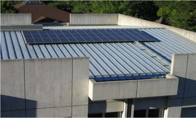
太陽光発電設備（TAUホール屋上）
